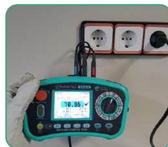
Pomiar impedancji pętli
